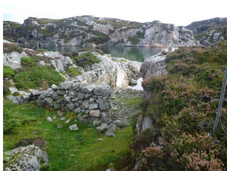
Naustet i Austrevågen, hvor skråtaket og dørene er borte (Falt ned rundt 1990).
