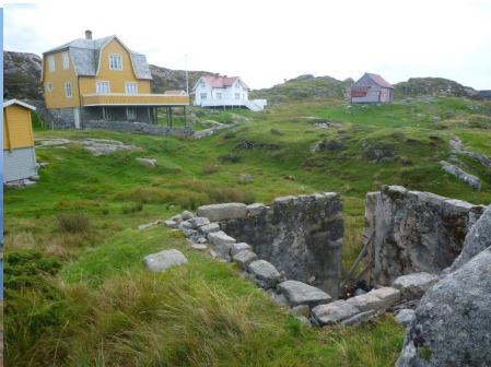
Potetkjelleren (i forgrunnen) mangler nå taket
